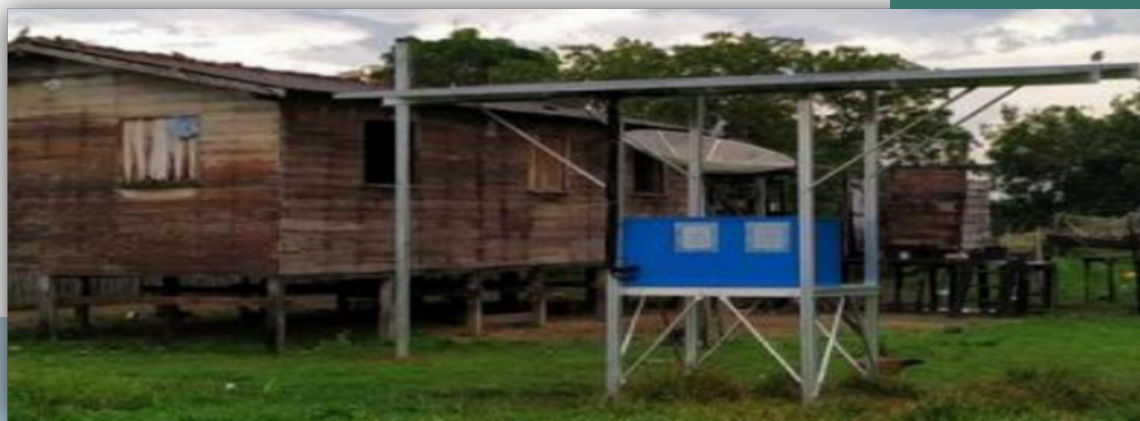
Figura - usina solar fotovoltaica com baterias em LFT em estrutura metálica suspensa
